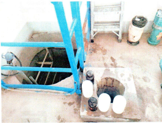
中水处理站出口（★1）
